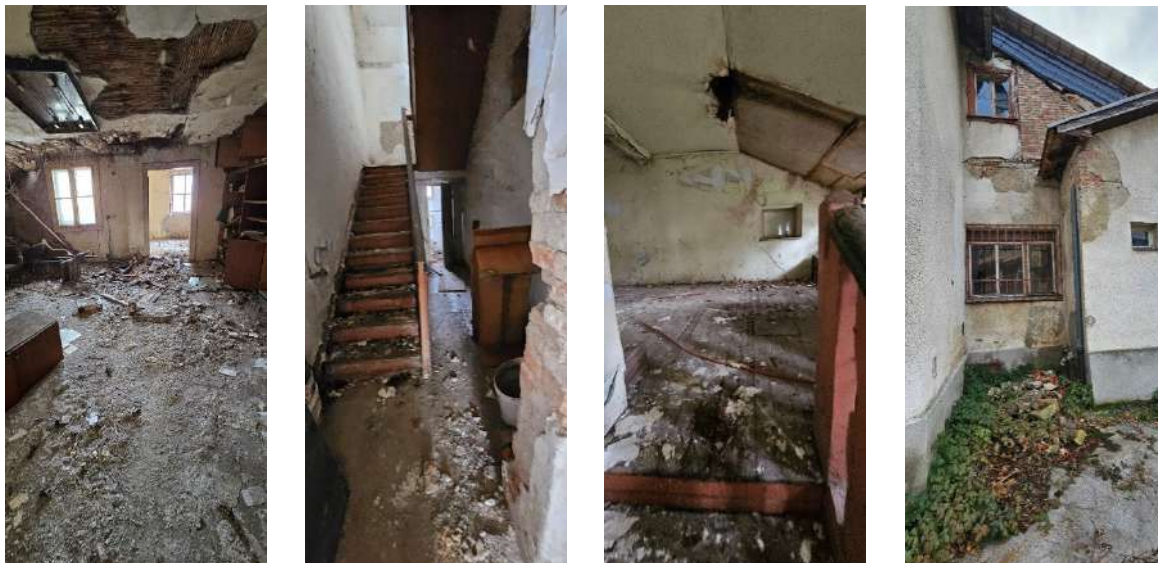
Fotografije oštećenih devastiranih podova, stropova, stepeništa i fasade objekta
